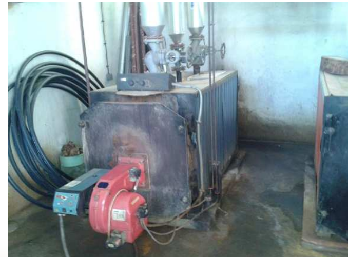
Foto: 1 Podvis kotao snage 400 kW u septembru 2014 (GIZ)
